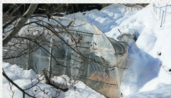
被害にあった育苗ハウス
